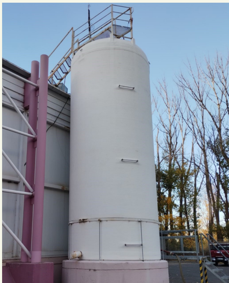
FIGURA 2. TANQUE DE ALMACENAMIENTO DE LA PLANTA DE PURIFICACIÓN DE AGUA DEL OBSERVATORIO AUGER .
